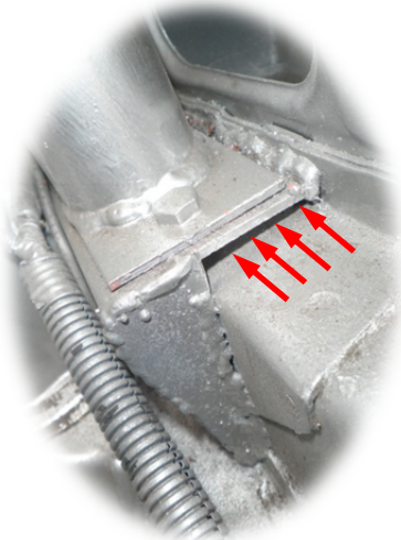
Placa de refuerzo no soldada por completo al chasis
