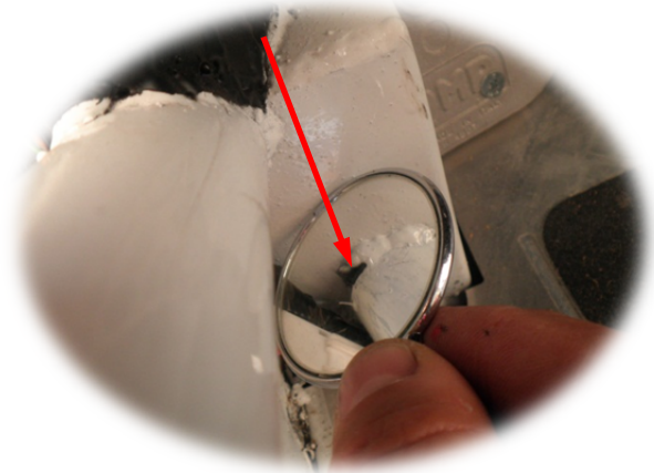
Tubo no soldado con el pie de anclaje a lo largo de todo el perímetro del tubo
